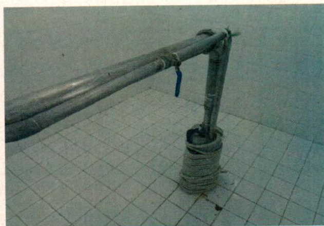
Captação da Fonte
